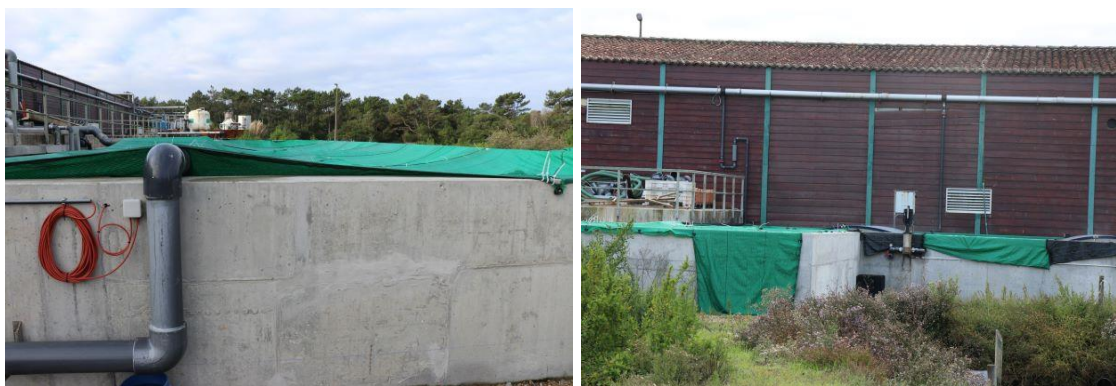
Figura 24 – Aspectos do novo tanque do novo sistema de tratamento de água.
