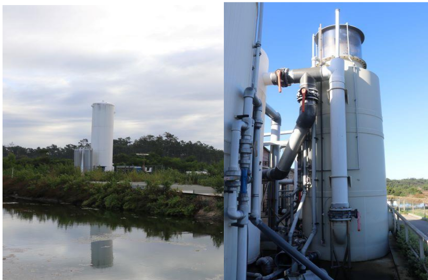
Figura 15 – A – Reservatório de O 2 ; B – Skimmers.
