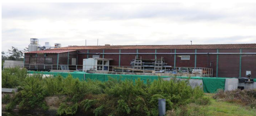
Figura 23 – Novo tanque do novo sistema de tratamento de água.
