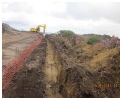
Fotografia 2: Exemplo de vale de cabos
