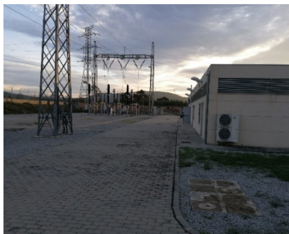
Fotografia 1: Subestação da Sr.ª da Póvoa
