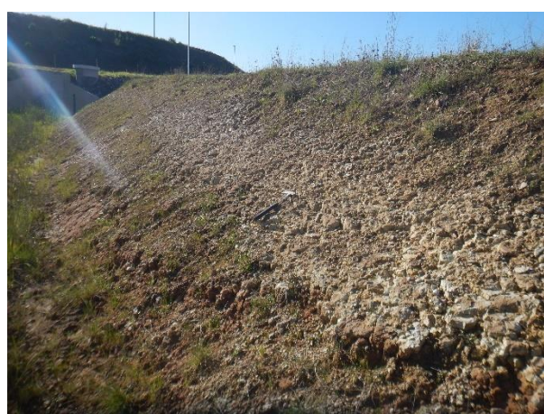
Fotografia 4.5.4 – Vista da vala junto à EE, onde se observam a intercalação de margas carbonatadas arenosas (PgM)
