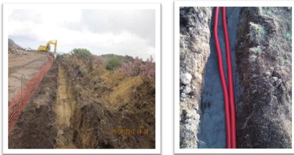
Fotografia 4.5 e Fotografia 4.6 – Exemplo de valas para cabos.
