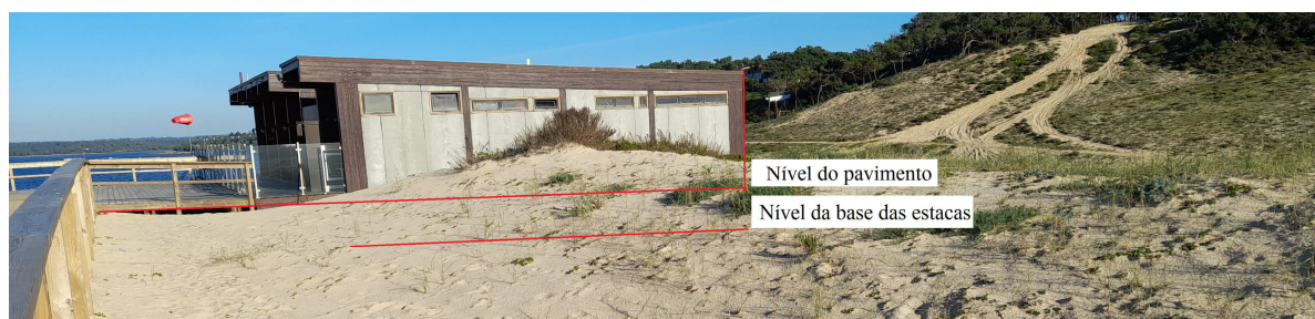
O efeito do acumular dos depósitos de anteriores dragagens junto ao restaurante da praia sul
