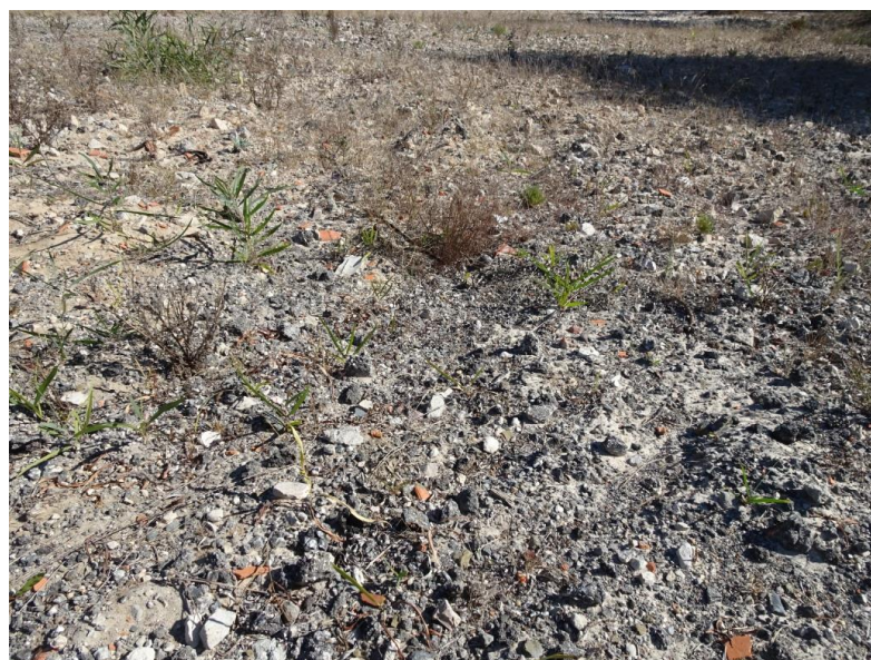
Figura 102 – Restos de pavimento precário
