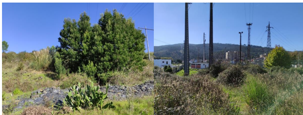
Fotografia 6.27 – Troço final da linha elétrica na chegada á subestação.
