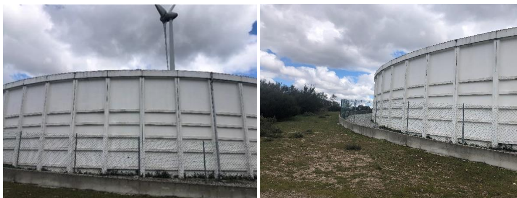
Fotografia 4.14 - Reservatório das ADT, localizado na área de estudo
