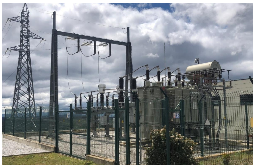
Fotografia 2.1 – Subestação associada ao Atual Parque Eólico de Trancoso, inserida no interior da área de implantação da Central Fotovoltaica
