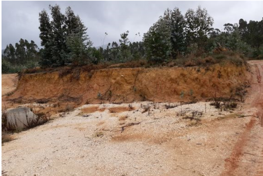
Figura 5 – Talude localizado entre o Lote 13 e 14.
