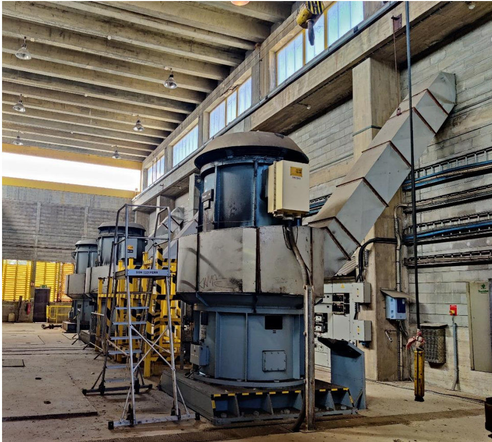
Fotografia 3 – Bombas das Tomadas de Água.
