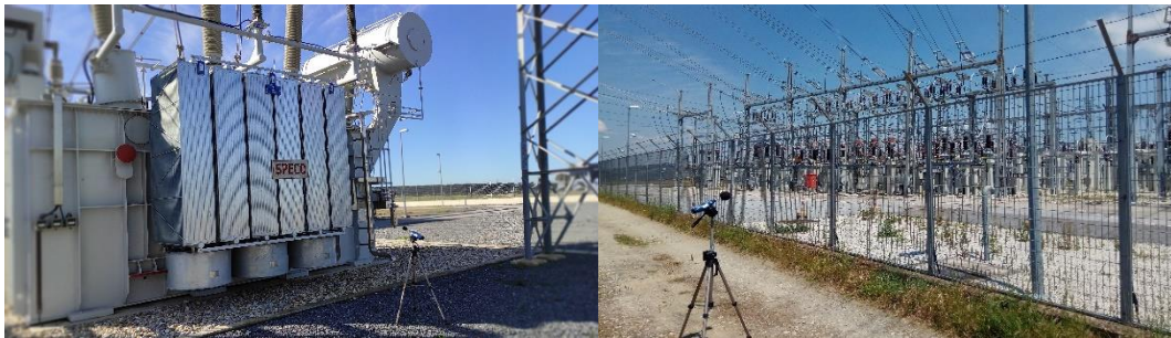
Figura 157 – Ilustração de medição em subestação com posto de transformação 400 kV
