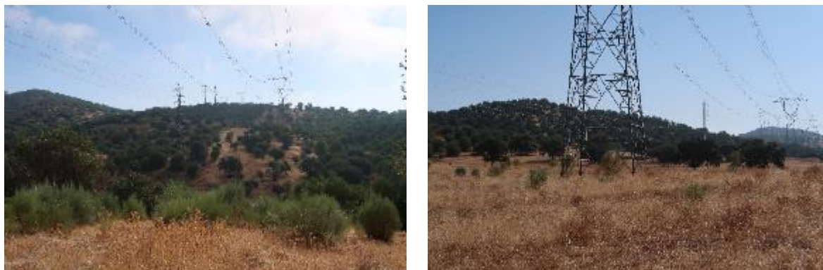
Figura 6-47 – Vistas do apoio 6 da linha Alqueva Divor e do apoio 7 da linha existente em direção à subestação de Alqueva.
