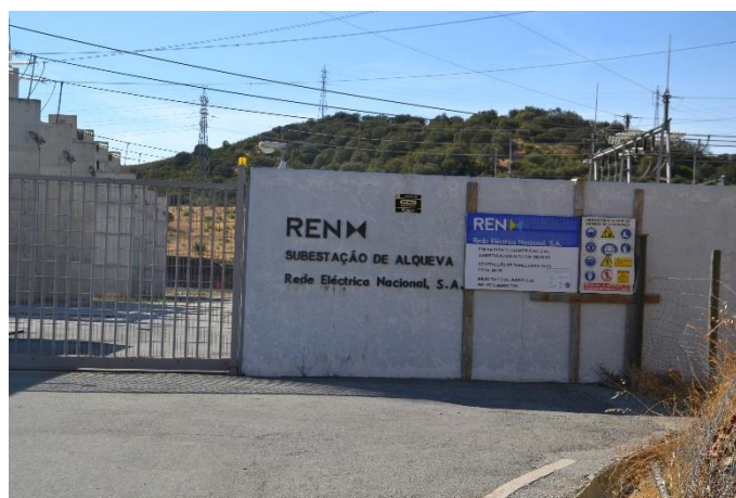
Figura 6-16 – Subestação de Alqueva.
