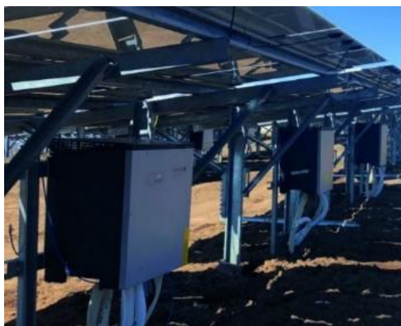
Fotografia 4.2 – Exemplo de inversor de montagem exterior
