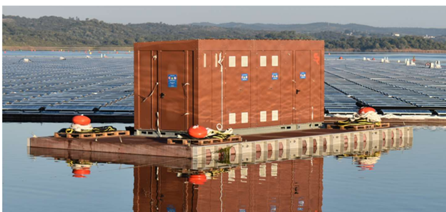
Figura 3: Postoo de Transformação e respetiva plataforma - solução independente
