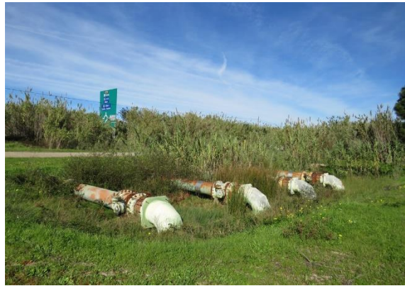
Infraestruturas de transporte de água.
