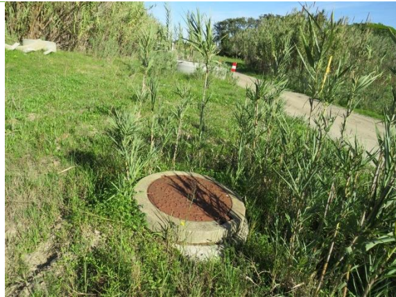
Infraestruturas da rede de saneamento.
