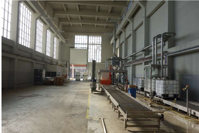
Fotografia 2 - Linhas de enchimento existentes na instalação.
