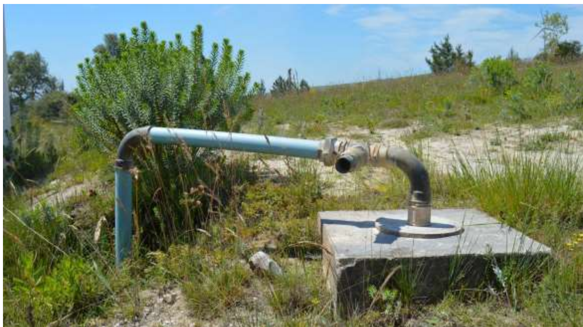
Figura III.25 – Furo vertical que abastece a pedreira.
