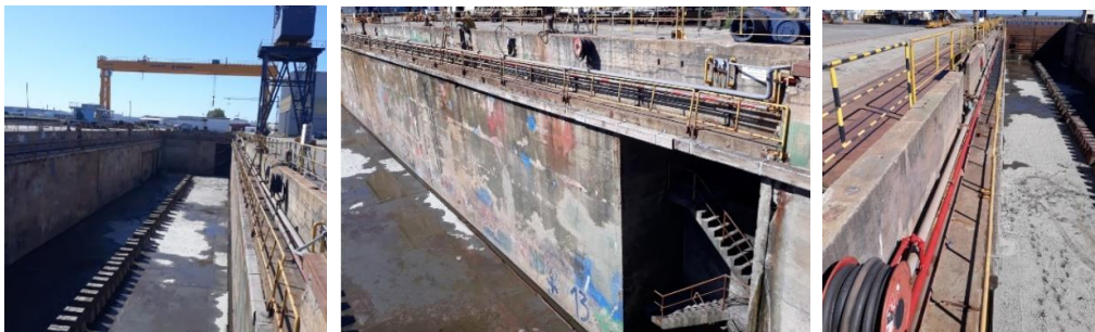
Figura 4- Doca seca: vista geral, acessos, passadiço interno e pontos de distribuição, doca cheia e fecho da porta da doca.
