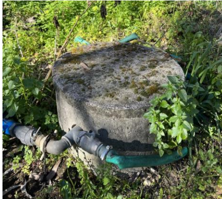
Figura 15– Captação de água subterrânea - Fonte: parecer setorial ARH
