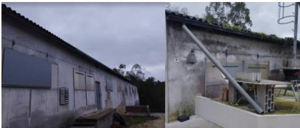
Figura 12– Evidências da necessidade de colocação de caleiras e "valas" para encaminhamento das águas pluviais- Fonte: parecer setorial ARH
