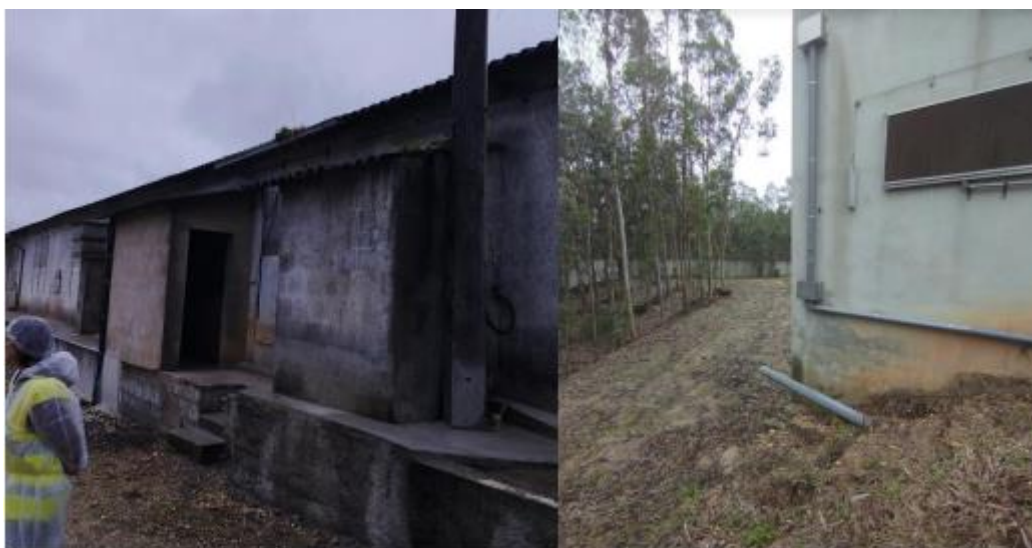
Figura 13– Evidências da necessidade de colocação de caleiras e "valas" para encaminhamento das águas pluviais- Fonte: parecer setorial ARH
