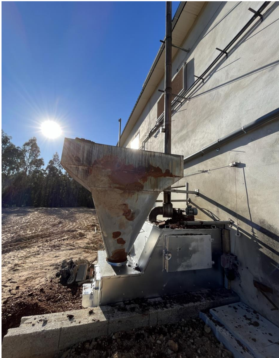
Figura 3.5.2. Gerador de ar quente, junto ao Pavilhão 3
