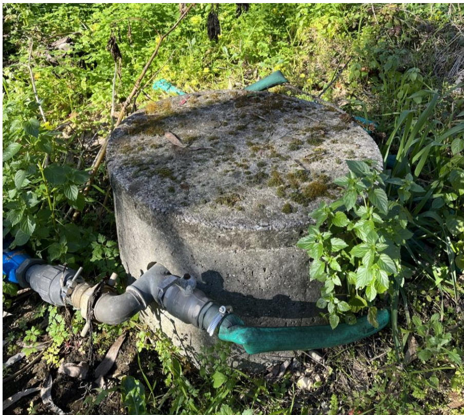
Figura 3.4.1. Captação de Água Subterrânea – AC1
