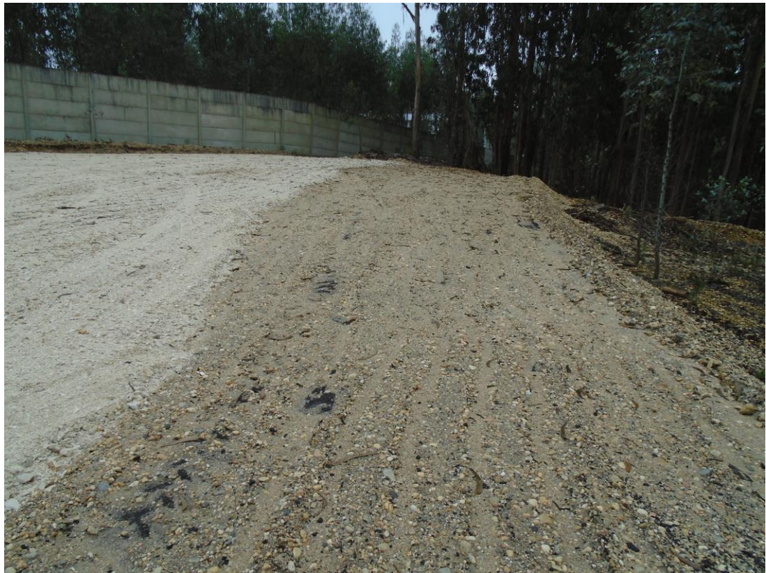
Figura 19 – Vista para Sul em local fora da propriedade, mas ainda dentro da área do projeto.
