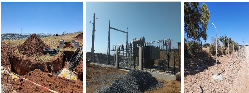
Ações construtivas dos diversos elementos: acessos, passagens hidráulicas, valas de cabos e subestação
