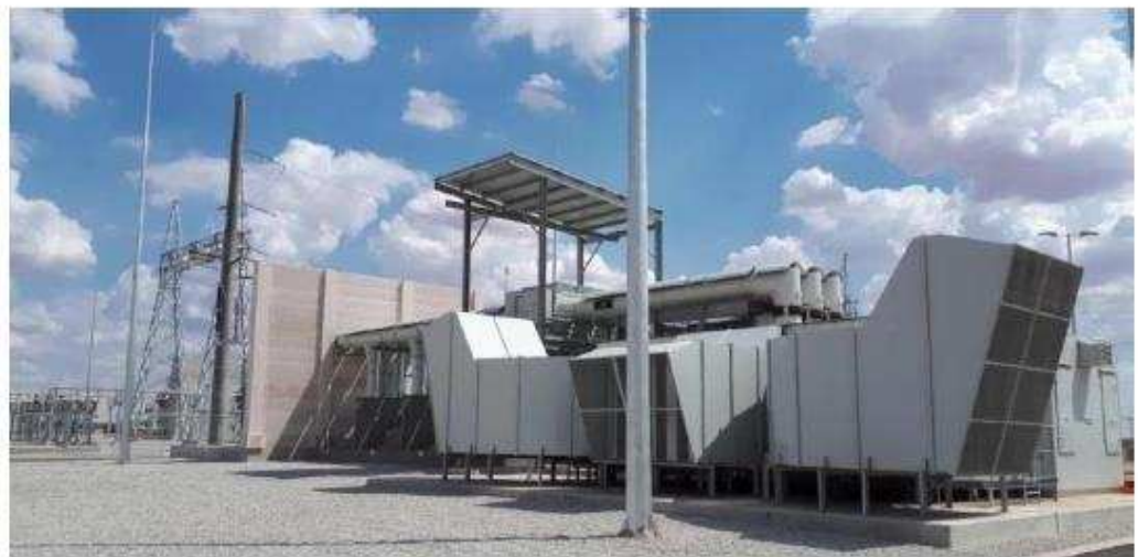
Figura 5.23 – Exemplo de como será a instalação de um Compensador Síncrono
