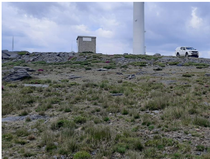
Foto 2 – Posto de Transformação
