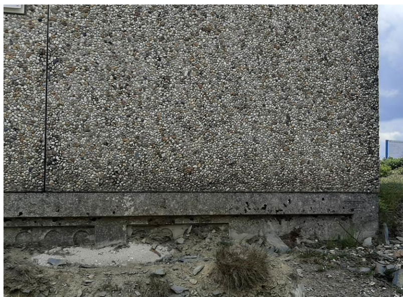
Foto 3 – Pormenor do Posto de Transformação
