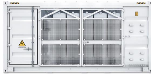
Figura 5.10 – Posto de Transformação
