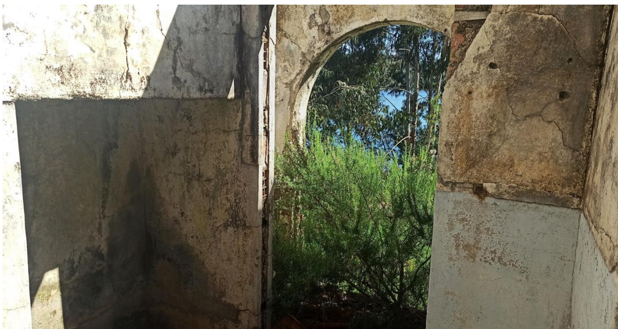
Figura 65: Vista do interior da Ocorrência C (no sentido do vão existente na fachada sul).
