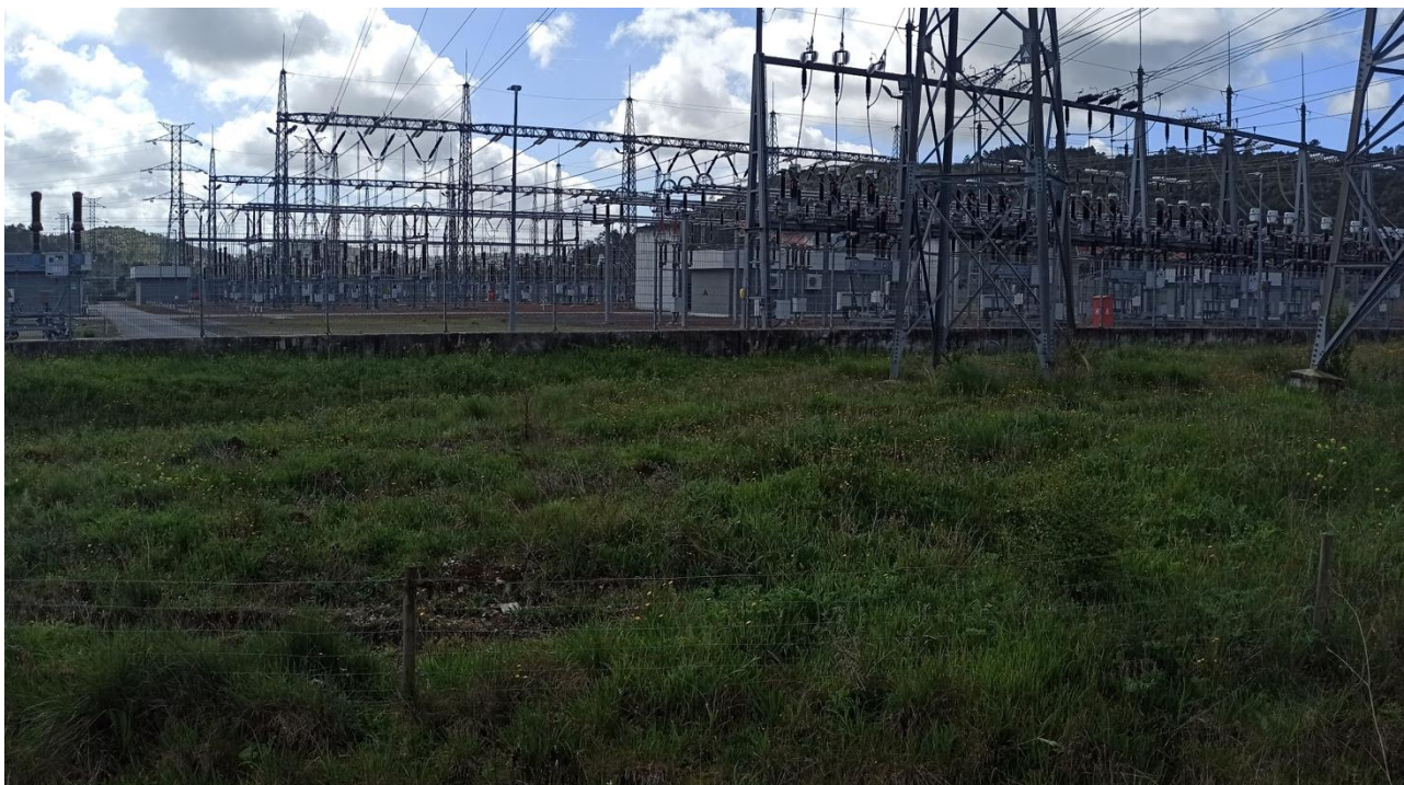
Figura 71: Vista da área de inserção da Linha Elétrica aérea a 60 kV na subestação da REN de Penela (ponto 1).
