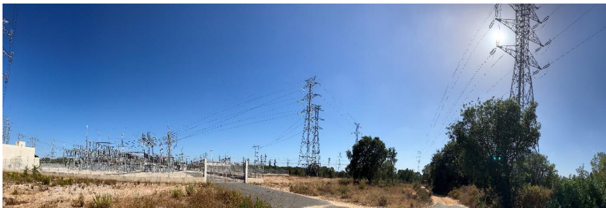
Figura 4.15 – Subestação de Sines e linhas associadas, onde se iniciam as LMAT da Galp, a 150 kV e da Start Campus, a 400 kV
