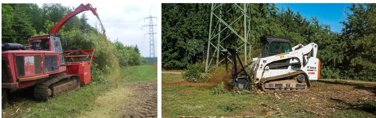
Figura 39 - Limpeza de matos mecânica: exemplos de destroçadores de martelos acoplados a diferentes máquinas
