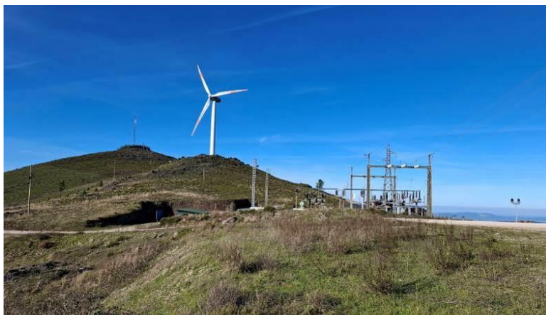
Foto 4-9 – Subestação (1.3.1.1) e acesso (1.4.1.1)
