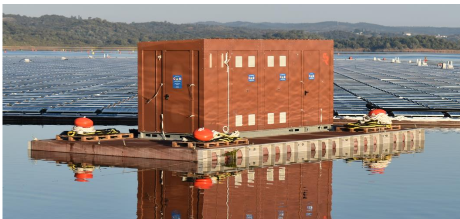
Figura 16: Centro de Transformação e Plataforma
