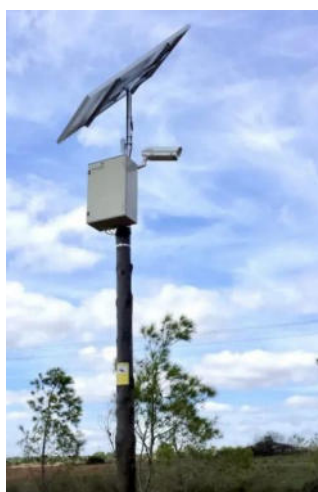
Fotografia 4.1 – Sistema CCTV utilizado em Centrais Solares Fotovoltaicas
