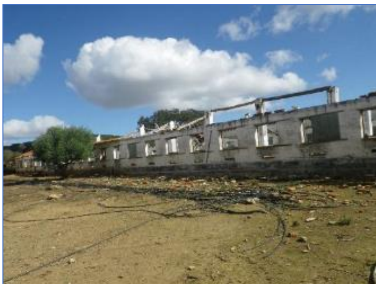
Figura 36 – Pavilhão 1, em ruína
