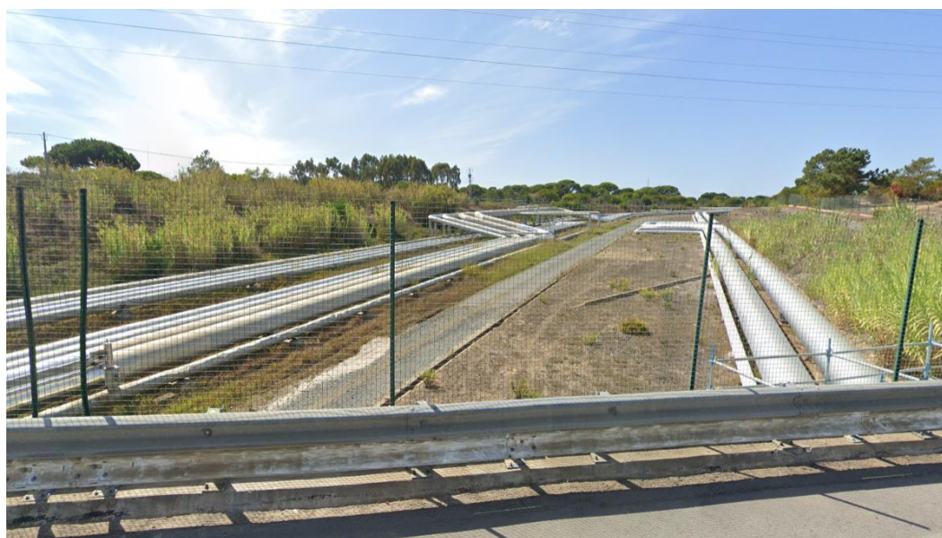
Figura 4.51 – Esteira de tubagens vista da A26-1
