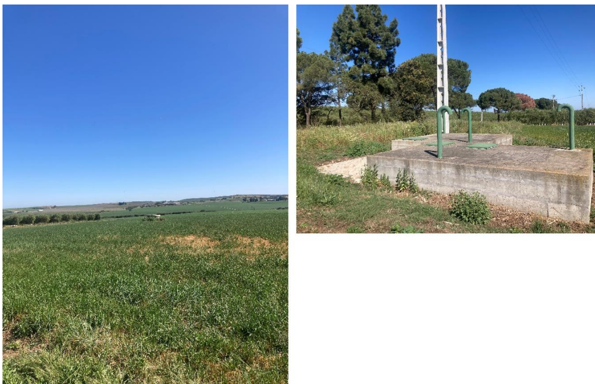
Figura 3.3 – Vista para montante da conduta CP1 (do nó 119) e câmara de válvulas na derivação para a C1.1 do Bloco 1 de Ervidel
