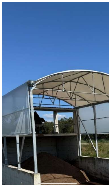
Figura 8.8 – Vista lateral para o tamisador existente
