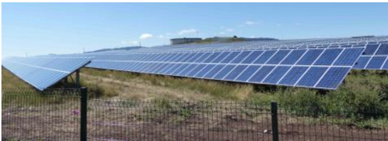
Figura 8.1 – Exemplo de central solar fotovoltaica
