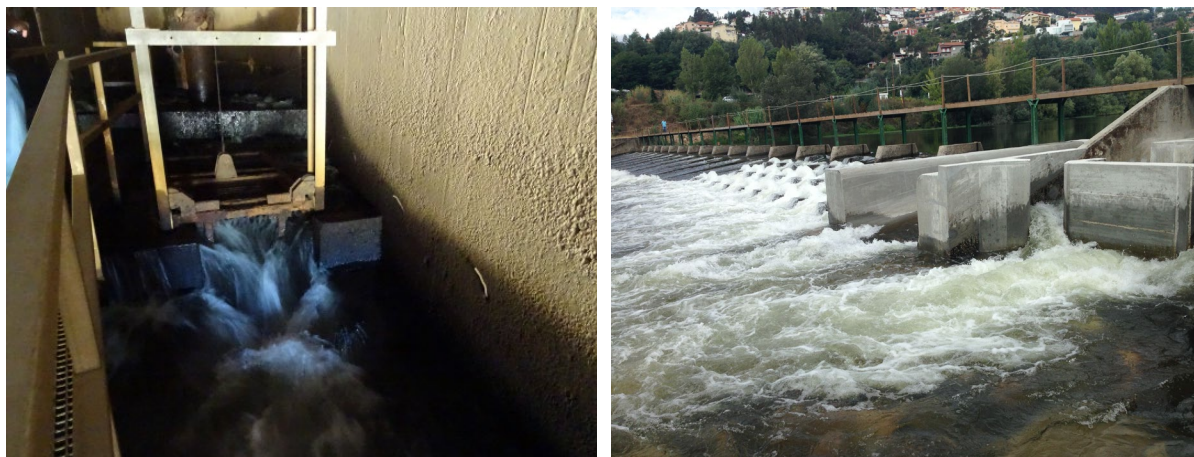
Foto 4.6 – Sistemas combinados de transposição instalados na barragem de Bouçoais-Sonim (à esquerda) e no açude do Reconquinho (à direita).
