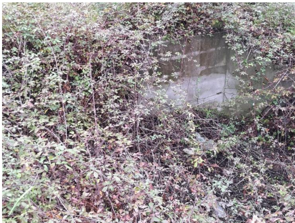
Fotografia 4.5 - Passagem hidráulica obstruída por vegetação
