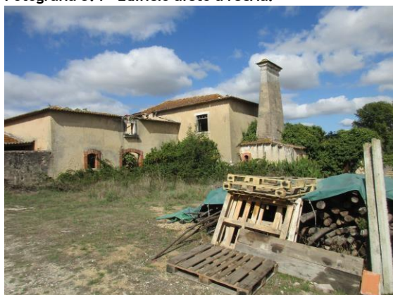
Fotografia 3.6 - Edifícios em ruínas - antiga habitação.
