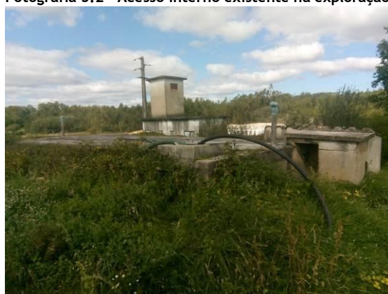
Fotografia 3.4 - Captação de água e depósito.
