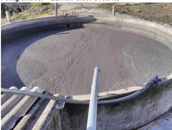
Fotografia 3.9 - Tanque de receção.
