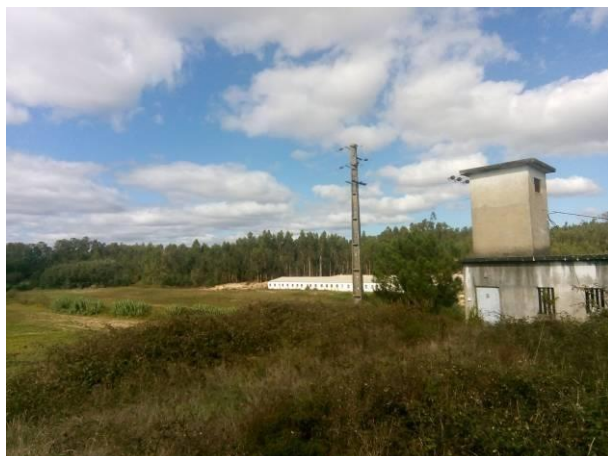
Fotografia 6.1 - Linha elétrica de média tensão que atravessa a área do projeto e respetivo posto de transformação.
