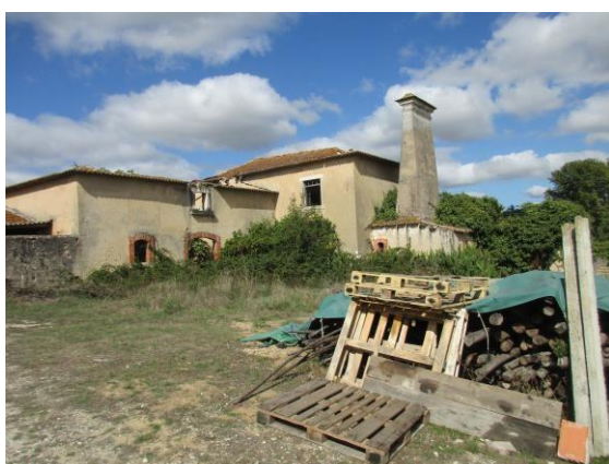
Fotografia 3.1 - Edifícios em ruínas - antiga habitação.
