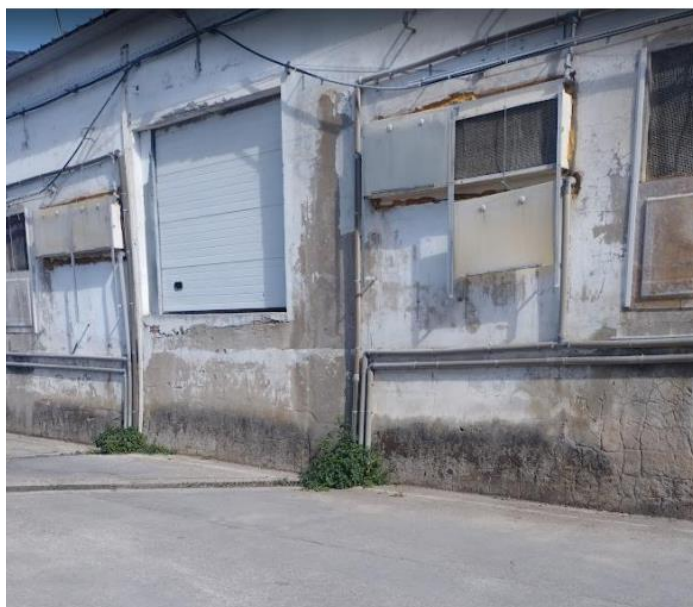
Figura 9: Evidências da necessidade de colocação de caleiras e limpeza das grelhas.
