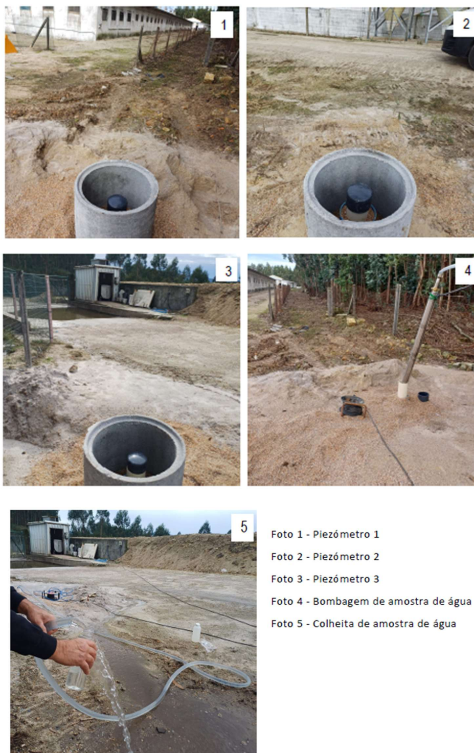
Figura 8 -Piezómetros de monitorização de água subterrânea
