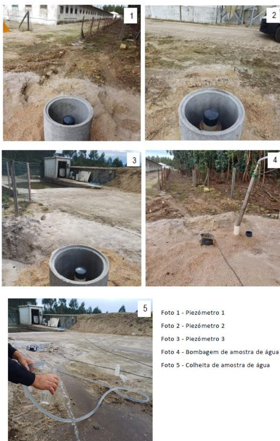
Figura 8.3 –Piezómetros de monitorização de água subterrânea
