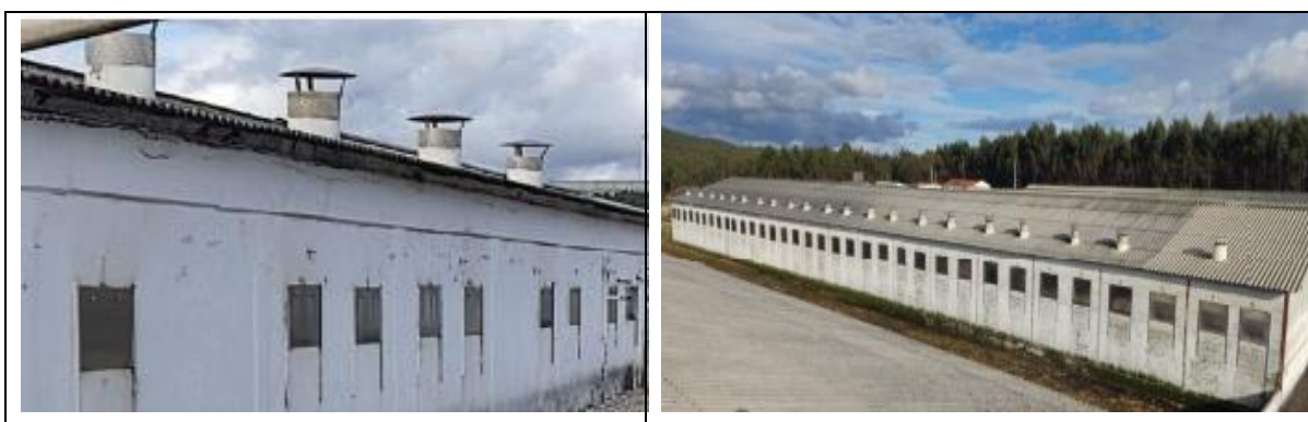
Figura 8.4 e Figura 8.5 -Saída de ar no telhado dos pavilhões
