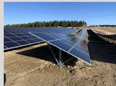
Exemplo da instalação de painéis solares
