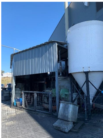
Figura 9 – Estação de tratamento de águas residuais da METAUTO
