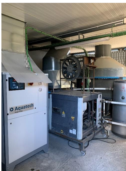
Figura 8 – Equipamento de refrigeração
