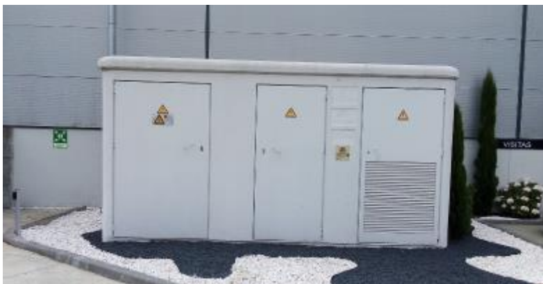
Figura 11 – Posto de transformação
