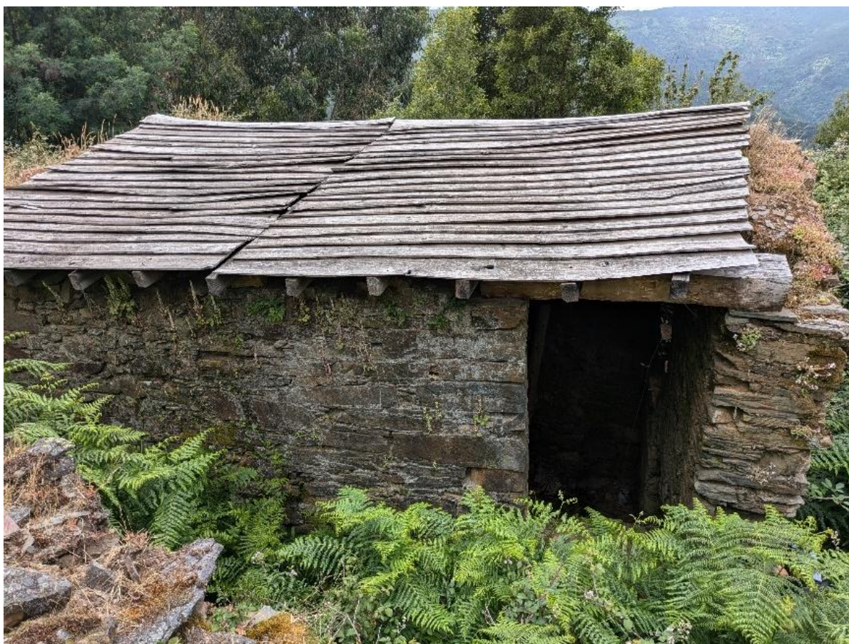
Figura 4.48 – Ruína com telhado em madeira em Silveira de Cima
