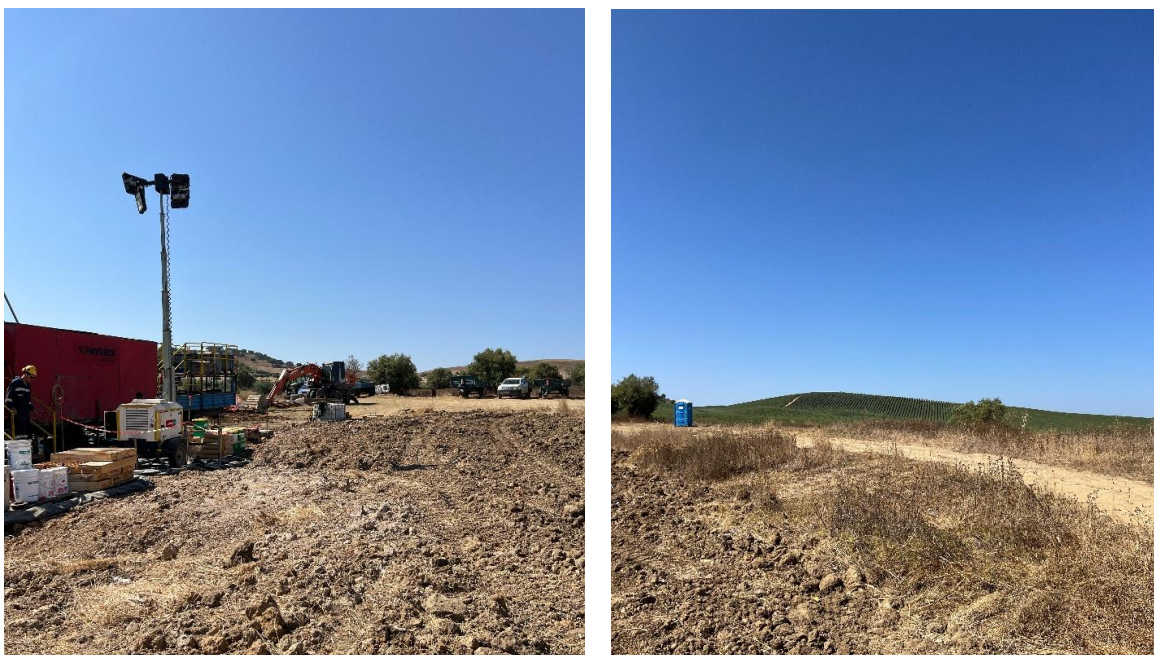
Figura 24 - Localização do Poço Principal. Fonte: Visita da CA dia 18/08/2026
