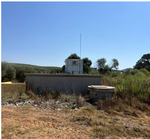
Figura 29 - Hidrante. Fonte: Visita da CA dia 18/08/2026
