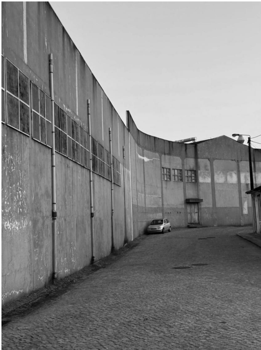
Figura 2 - Visão Geral junto à empresa Nortecnica, caleiras a necessitar de manutenção
