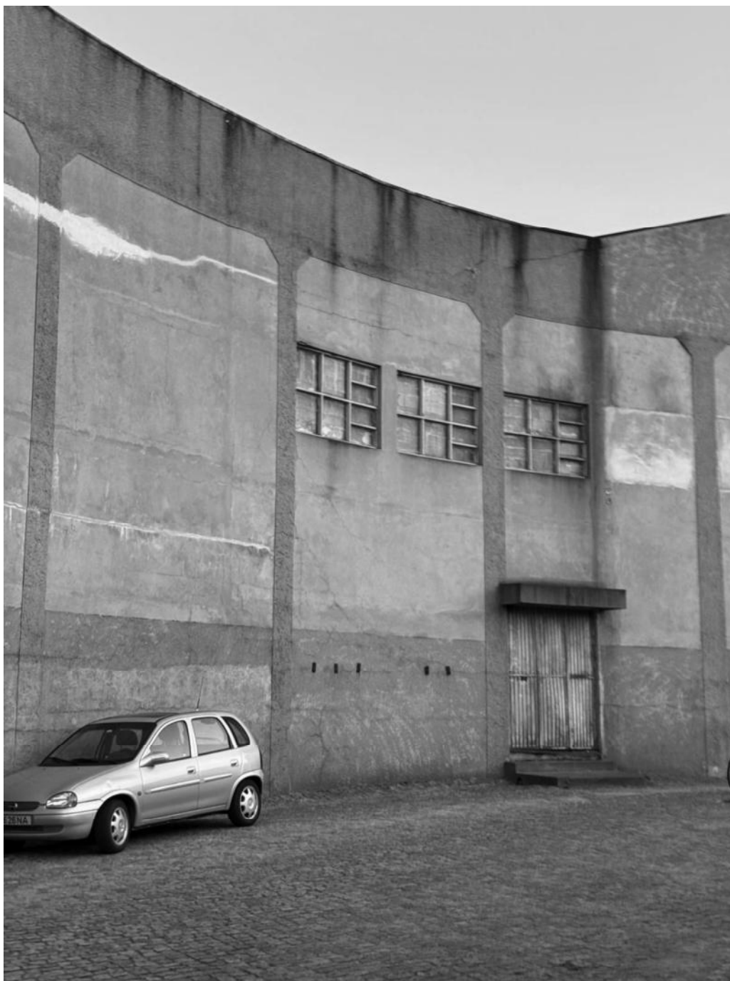
Figura 3 - Portão degradado, zonas sem janelas e sem passeios
