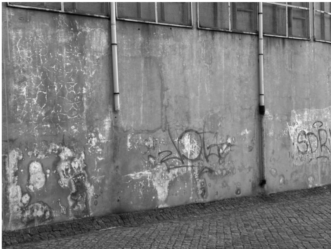
Figura 1 - Traseiras Norte da Monteiro Ribas, sem passeios e caleiras degradadas escoando para a via pública
