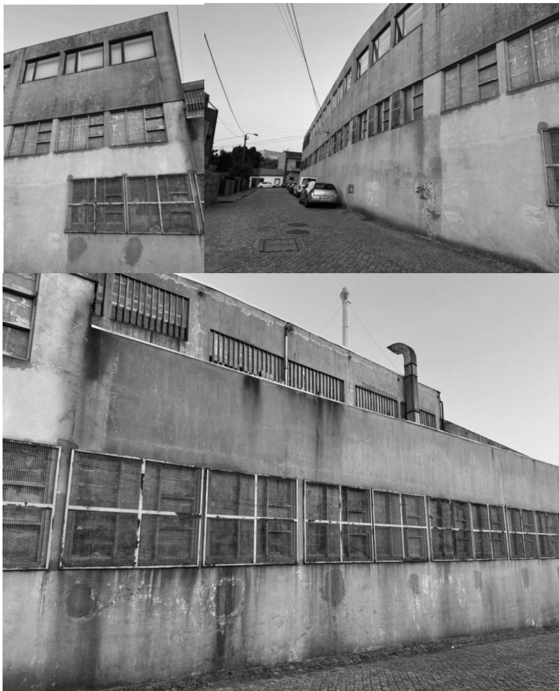
Figura 5 - Degradação das instalações na totalidade da fachada Norte
