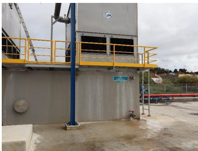
Fotografia 3.8 - Torre de refrigeração.
