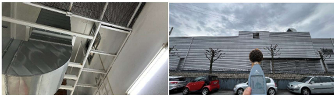
Figura 53 - Ventilador antigo e a sua localização vista do exterior da fábrica.
